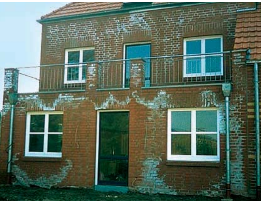
Salzausblühung an einer Fassade.
